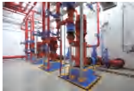
消防水泵房部件标高一致，检修空间布置合理
